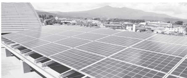
▲市役所に設置された太陽光発電パネル
