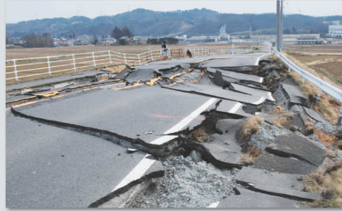
市道富士内・上沢線。アスファルトは胎細工を壊したようにバラバラに
