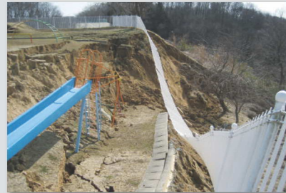
園庭は西側の法面が崩落。フェンスや滑り台も崩れ落ちた
