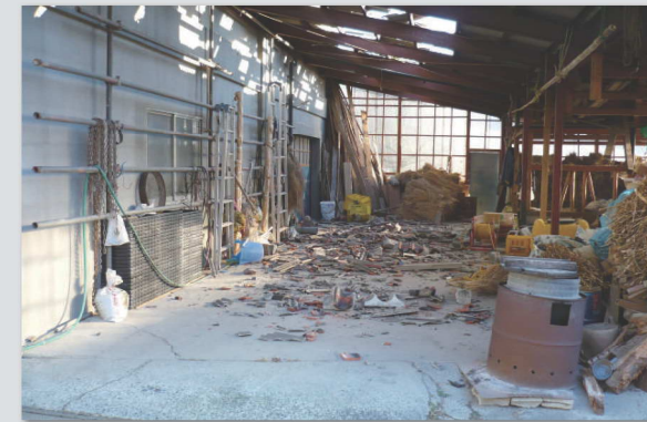
一般住宅、瓦が作業小屋の屋根を突き破る
