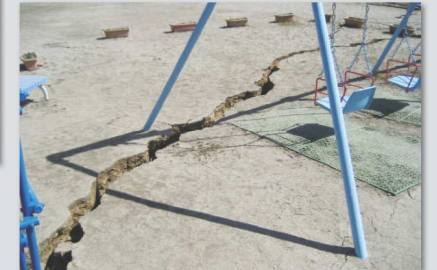
地割れが発生した園庭
