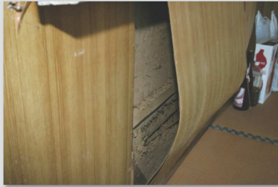
内壁の合板がはがれたほか、天井の一部もはがれた
