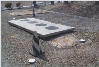
長屋分館、合併処理浄化槽隆起損壊
