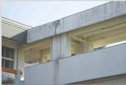
渡り廊下のモルタルが剥離して落下
