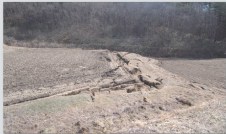
稲沢字堂平の水田法面が崩落
