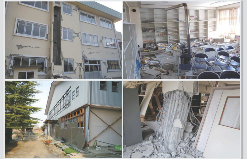
(左上) 北側から撮影した南校舎。壁面全体に破損箇所や亀裂が走る (右上) 図書室の本はほとんどが棚から落下 (左下) 体育館の壁が崩落して、鉄骨と木材がむき出しになった (右下) 南校舎1階の理科室の鉄筋コンクリート柱の状態
