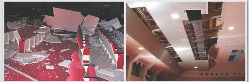
しらさわカルチャーセンターの天井板が落下
