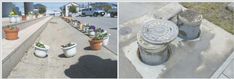
昇降口の下の舗装が沈下（写真左）。保健室前のマンホールのふたが持ち上がった
