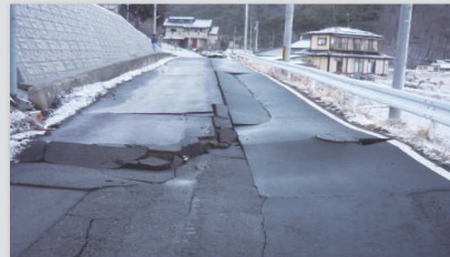
青田字碧森地内、市道碧森線。道路に亀裂が走るマンホールが隆起
