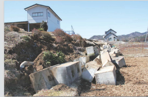
青田字寄松地内、積み石崩落
