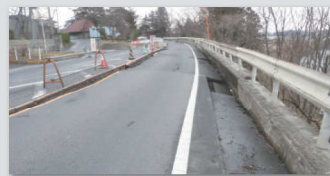
写真左右とも岩根字本郷地内、県道本宮・熱海線。センターラインから南側五百川沿いの土手が崩落し、道路が陥没
