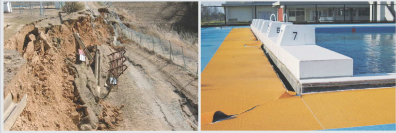
校庭東側の法面が崩落。通路が寸断され、側溝なども崩れ落ちた（写真左） 地滑りによりプールサイドの沈下や亀裂が生じ、プール槽も約10センチ傾いた（写真右）
