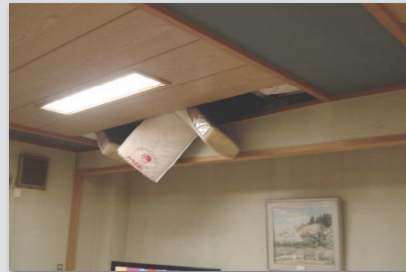
糠沢分館天井板破損
