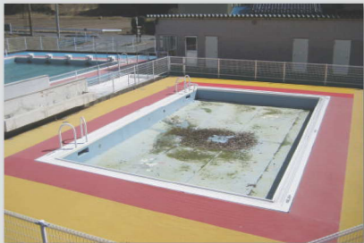
低学年用のプールが漏水。使用不能となった
