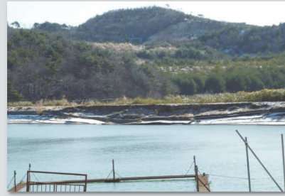
岩根の大池、堤体崩壊
