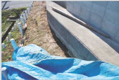
敷地北側法面が崩落。建物内でのモルタルの土間に亀裂が入った
