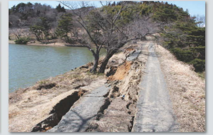
蛇ノ鼻中ノ池堤体崩壊
