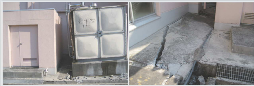
(写真左) 貯水槽の基礎が崩れ、傾くタンク。(写真右) 犬走りのコンクリートも割れた
