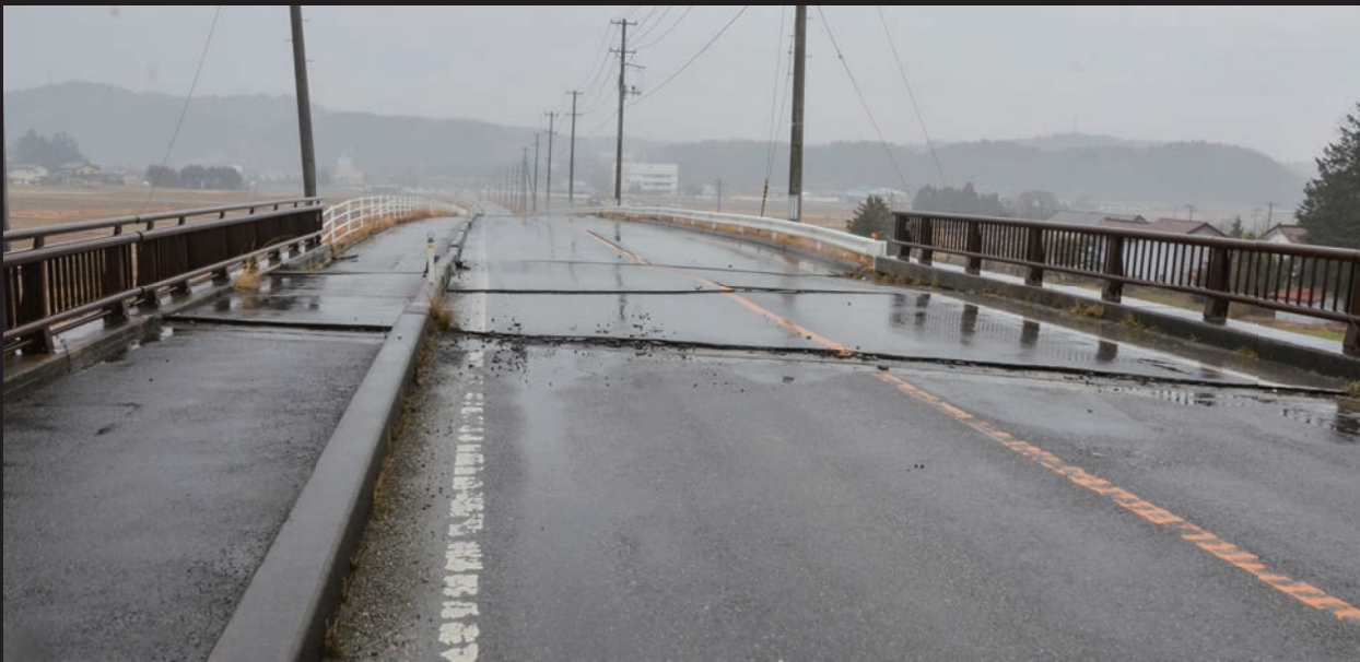
▲路面の沈下により、段差が生じ、通行止めとなっている市道富士内・上沢線（仁井田字四合田地内）
