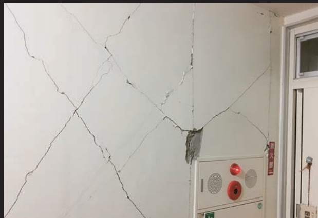
▲壁に亀裂が入った五百川小学校図書室前
