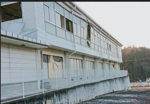
▲壁に亀裂が入り窓がゆがんだ白岩小学校体育館
