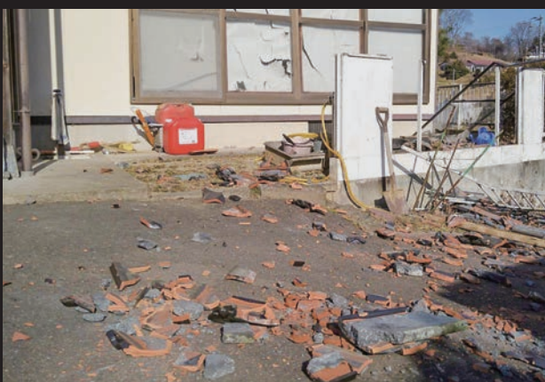
▲屋根瓦がはがれ、地面に散乱する民家
